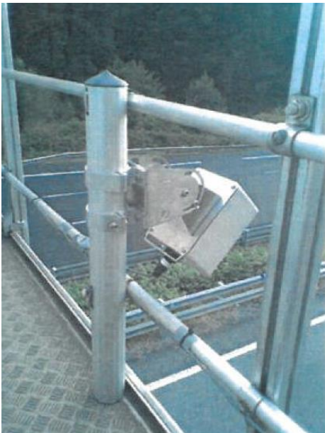
Figure 1 Radars TMS-NET utilisés sur les autoroutes et les routes 2x2 limitées à 90 km/h
